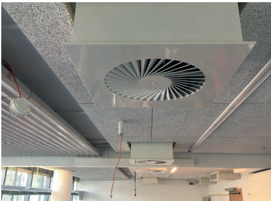
Während der Bauphase am Neuen Kranzler Eck: Das Umluftdeckengerät LH-UL 250 ist als Standardgerät mit einem Ionenerzeuger vom Typ LH-MAG 1000 sowie einem Ozonerzeuger vom Typ LH-03 bestückt.
